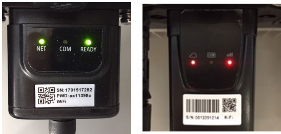
Figura 33 – Stato di comunicazione irregolare tra inverter e WiFi
