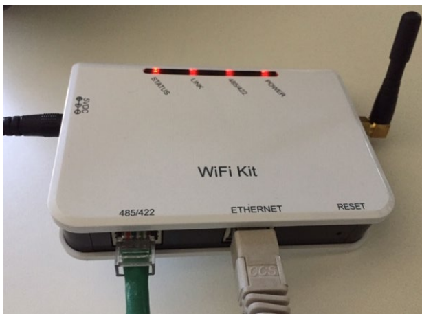
Figura 92 – Cavo Ethernet collegato al datalogger
